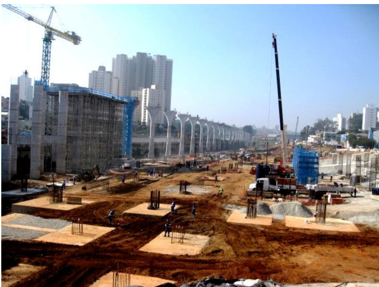
Figura 91 – Reservatório ocupado pelas obras do monotrilho (Linha17-Ouro do Metrô) e da Estação Jardim Aeroporto. Foto da autora tomada em 22/07/2014 entre 10h e 11h30min.
