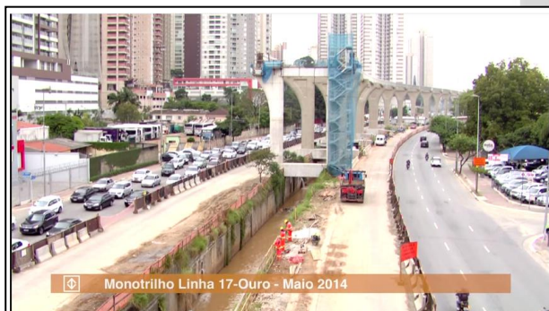
Figura 88 – Monotrilho em construção. Imagem recortada de vídeo institucional do METRÔ aos 0:25 minutos. (SÃO PAULO – Município, STM, 2014)
